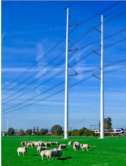
Abbildung 8: TenneT Wintrack-Mast (Niederlande)
