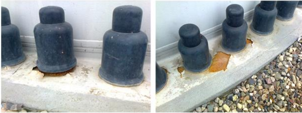
Abbildung 12: Korrosionsprobleme im Flanschbereich bei Vollwandmasten
